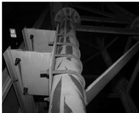
門型標識取付部の劣化
