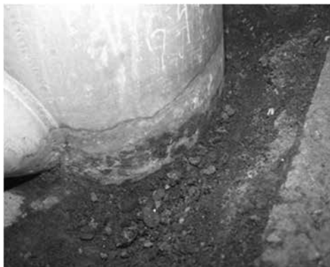
門型標識支柱基部の腐食
