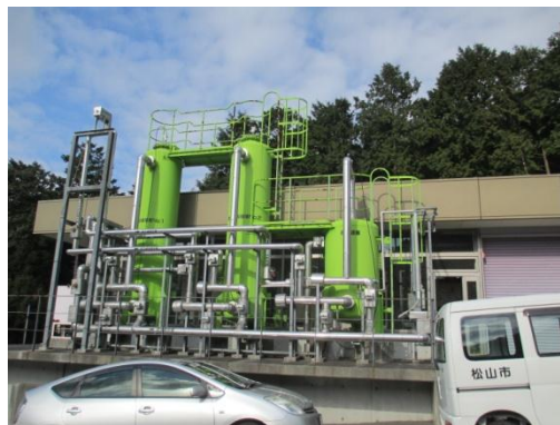
<表流水・簡易浄水処理棟>
