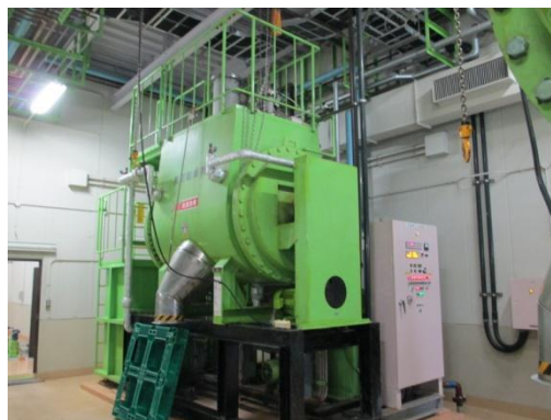
<浸出水処理施設②>
