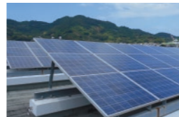
屋上においた太陽光パネル(中島)
