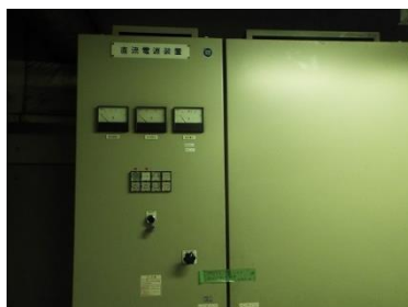
【電気室（直流電源装置の故障）】
