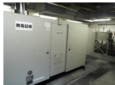
【電気室（非常用発電機の劣化）】
