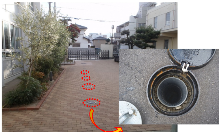
災害用マンホールトイレの設置状況（例）
