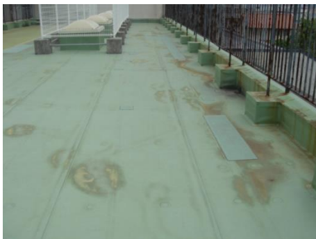
D 判定：防水層に膨れ・破れ等
