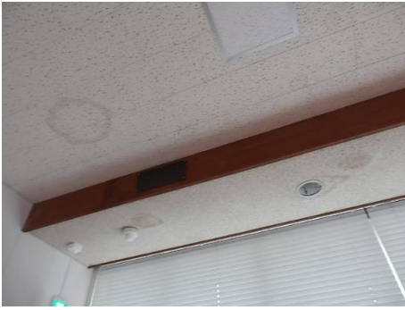
D判定：雨漏り痕
