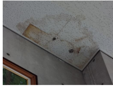
D判定：雨漏り痕
