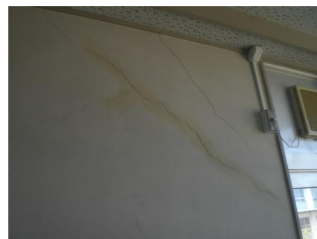
D 判定：亀裂
