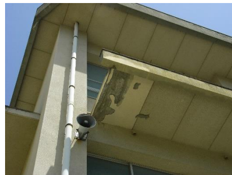
D 判定：鉄筋の露出
