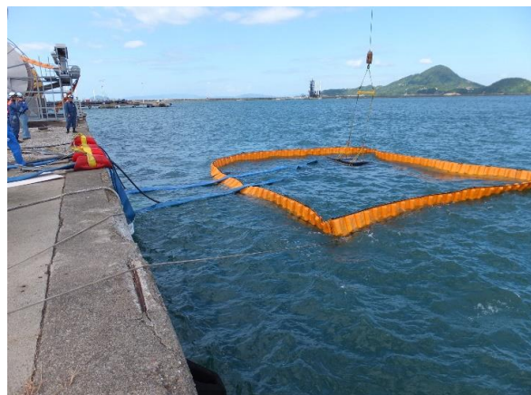
14 大容量泡放射システム設置状況③
