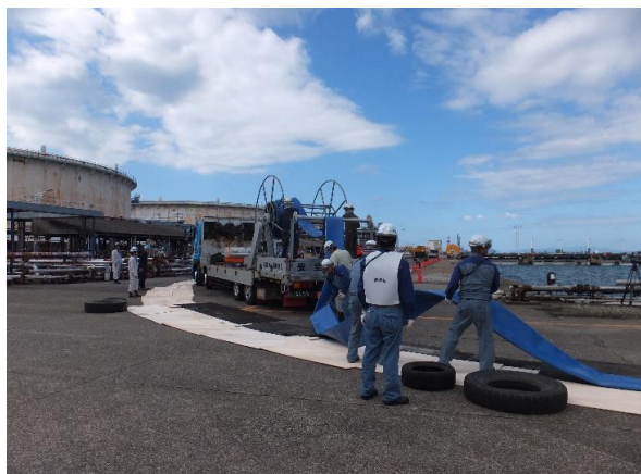
13 大容量泡放射システム設置状況②
