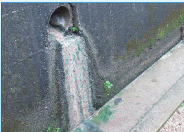
(例)生活雑排水が未処理で流れている水路
