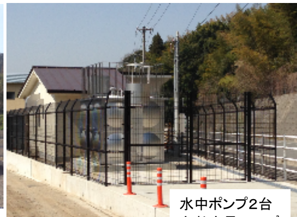
中継ポンプ場
