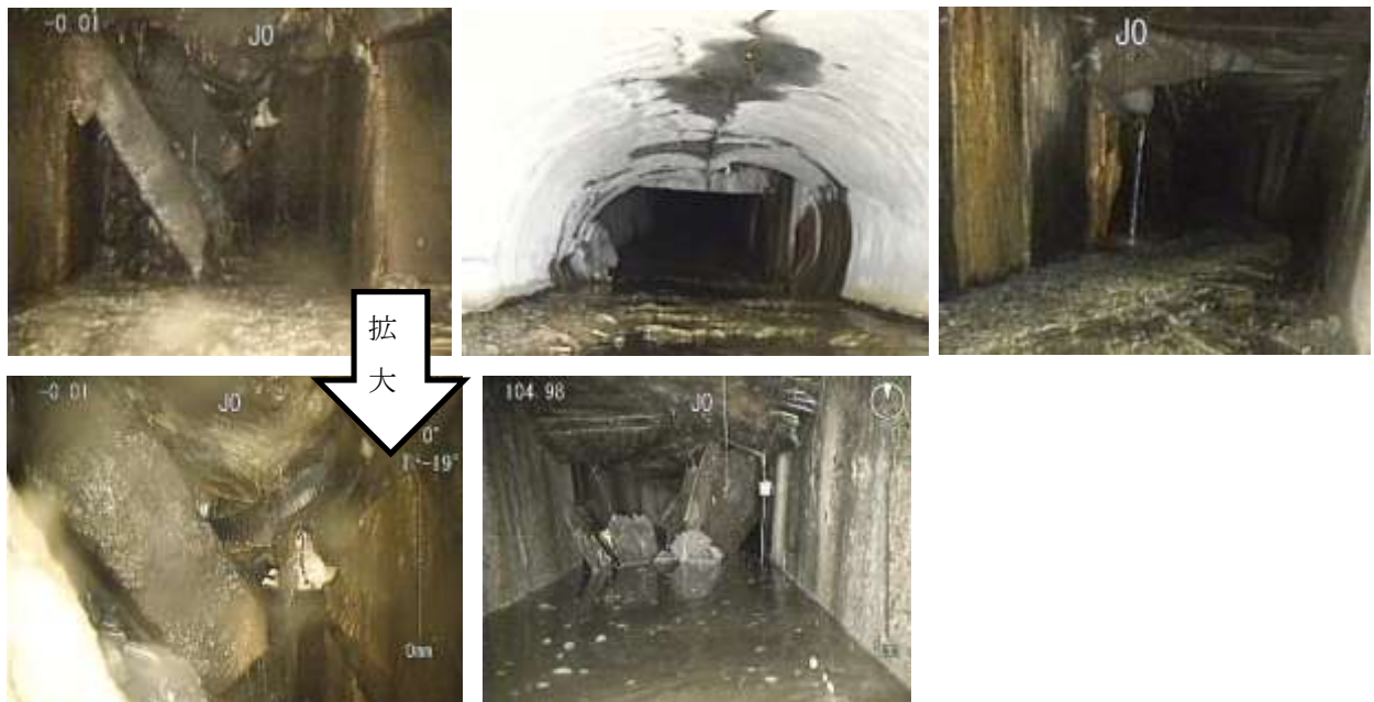
図 I - 1 0 地下水路床板崩落(左上、下段)、地下水路亀裂(中上)、地下水路への地下水流入(右上)
