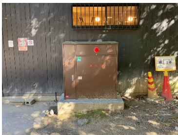
消火設備（消火栓）
