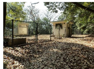
水道設備（県庁裏配水池）
