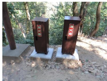
消火施設（消火器）
