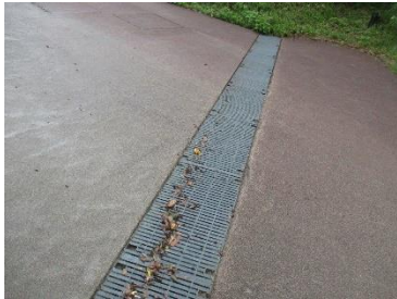
排水設備（暗渠）
