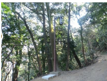
電気設備（照明）
