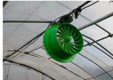
循環扇の設置状況
